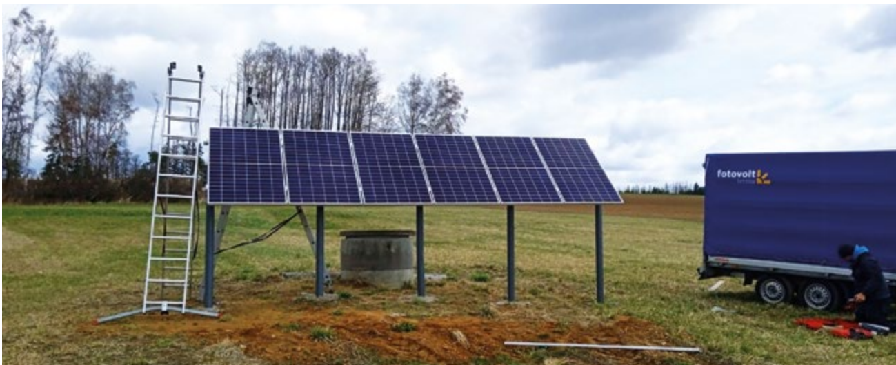
Budoucností lokální energetiky mohou být i opravdu drobná řešení jako je např. mikro-fotovoltaický systém používaný výhradně pro čerpání vody do rybníka na kopci v obci Okrouhlice
