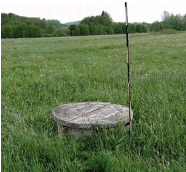
Obr.22: Drenážní šachta nad zatrubněným potokem
