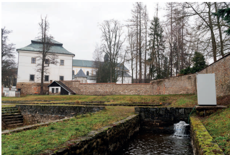
Ždár nad Sázavou - mikro vodní turbína umístěná na výtoku zámeckých sádek
