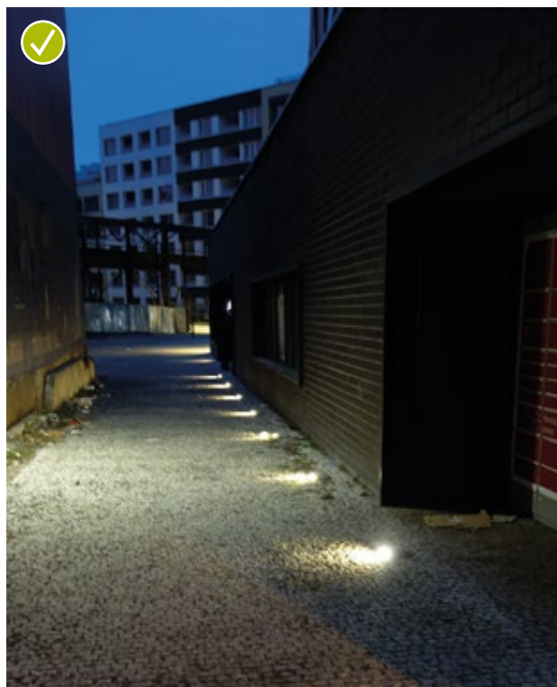
Současné technologie LED nabízí pokročilá řešení s integrovaným umístěním a směrováním světla pouze tam, kde to lidé potřebují. V kombinaci se světlou dlažbou mohou příkony svítidel klesnout i pod 1 W a tmavý matný povrch reflektoru účinně omezuje riziko oslnění (Praha 7).
