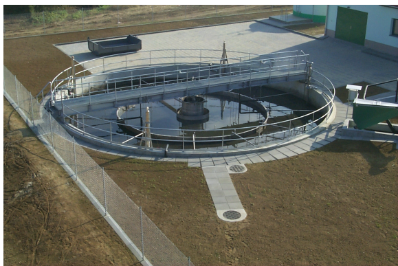
Obrázek č. 4: Čistička odpadních vod od r. 2003
